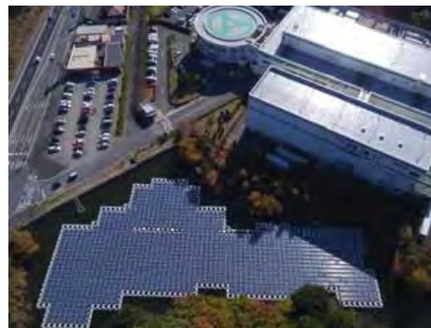
嵐山大沼水上太陽光発電所
